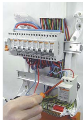
16 - Raccordez les autres dispositifs devant équiper le tableau électrique (transformateur, contacteur jour/nuit...).
