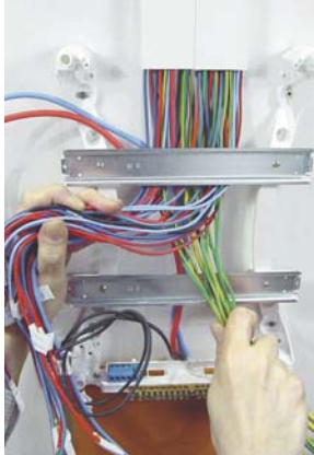
5 - Séparez les conducteurs de terre de leur ligne, puis regroupez-les vers le bas du tableau.
